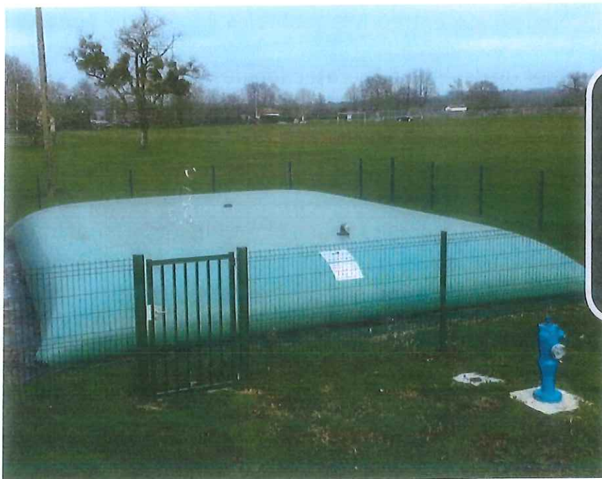
Exemple de défense incendie
